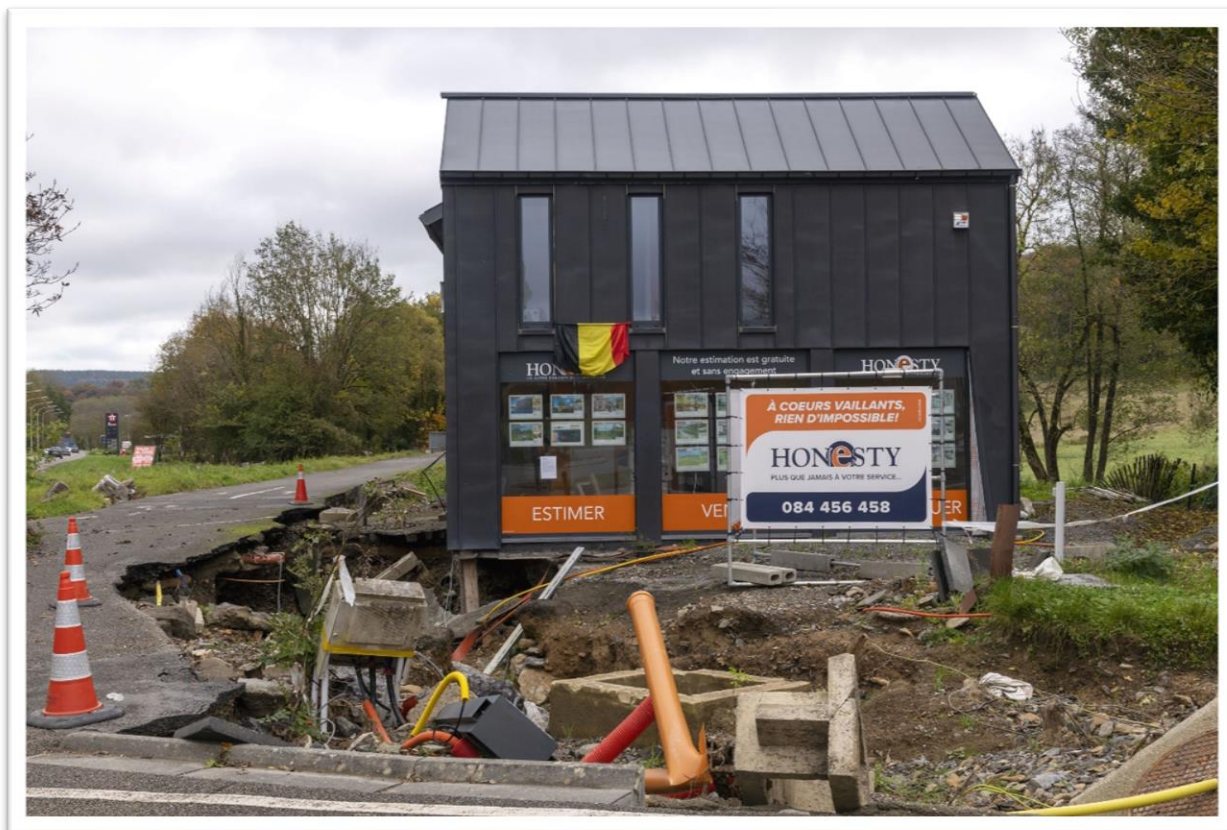
Illustration des dégâts subis par certaines entreprises (ROCHEFORT)
